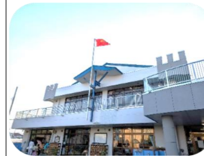
社会福祉法人愛宕会 あたご保育園 （外壁改修工事 令和4年度実施）
